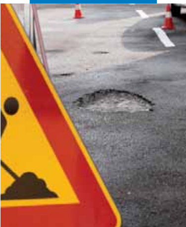
Silniční výtluk připravený k opravě
